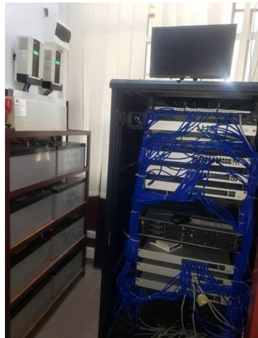
Le serveur installé à l'IPPS pour la connexion au Wifi @Bnagoura/IPPS
